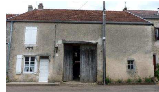
Enduit couvrant en ciment – ferme Grande rue à Perrancey
