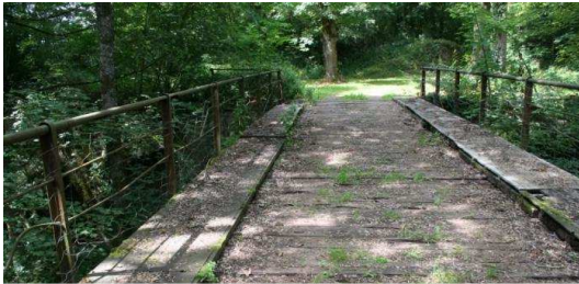
Dégradation du pont du fort de Peigney
