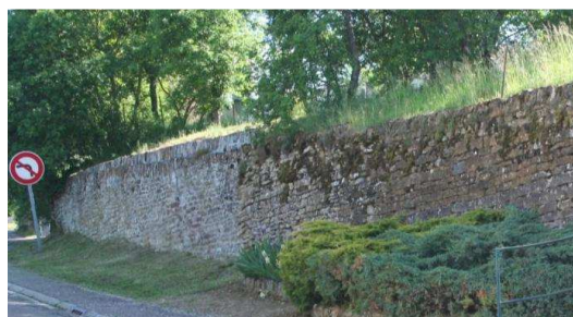
Jointolement d'un mur servant de soutènement. En l'absence de barbicanes, l'eau reste piégée dans les terres soutenues
