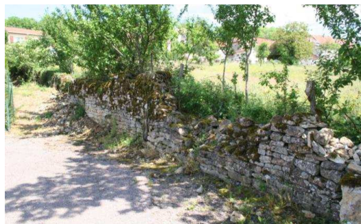
Brèche dans un mur en pierre sèche
