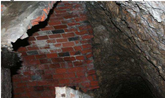
Voûtes effondrées et linteaux brûlés dans l'ouvrage de Perrancey
